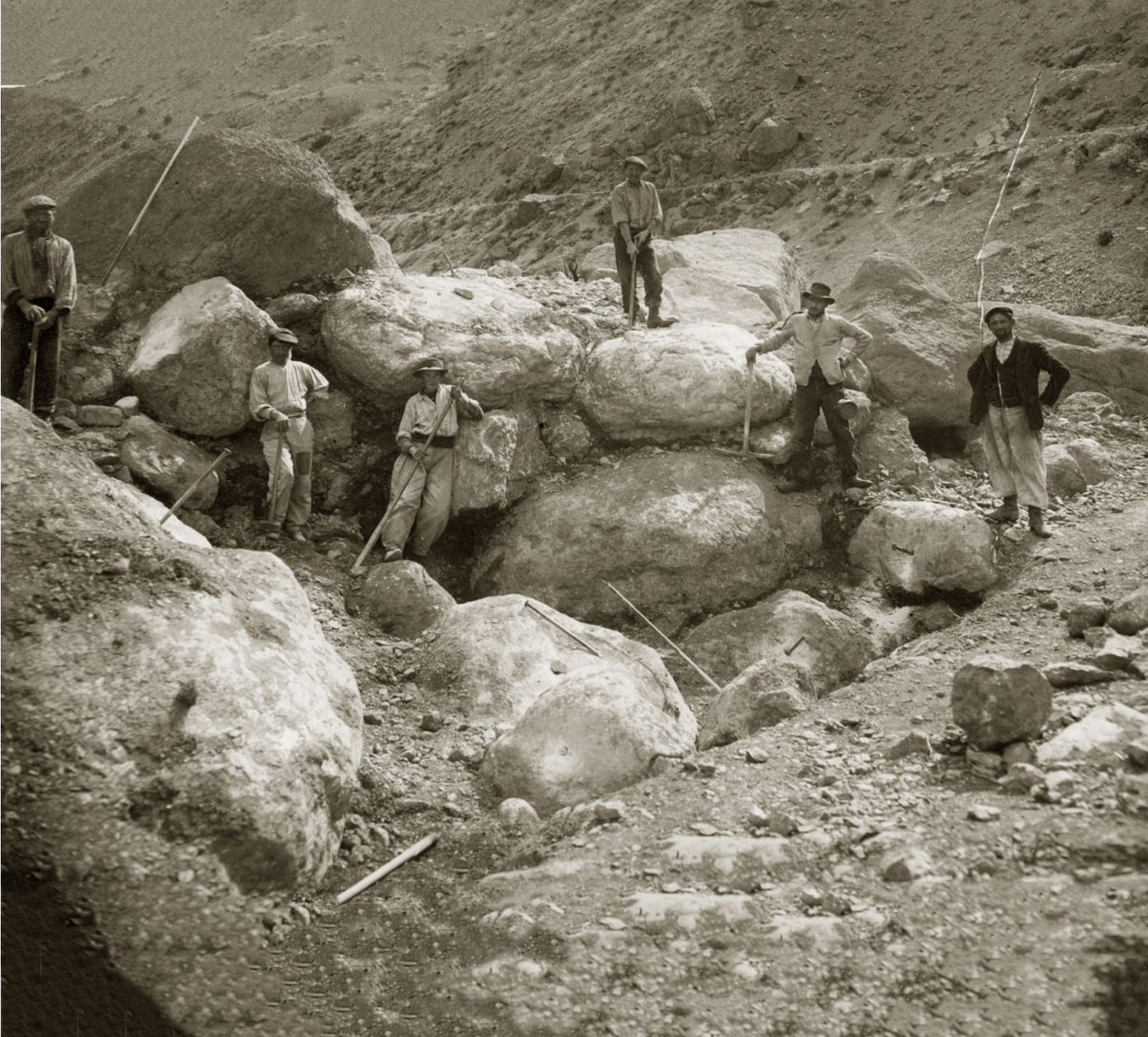
Les fouilles d'un pont sont réalisées au milieu de très gros blocs
